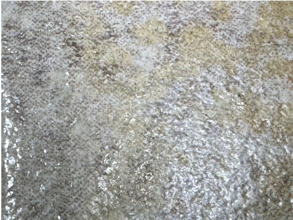
Foto 9 Test panel med opløsning 1:3. Asbest forsegleren dækker hele overfladen. Man kan se at påføringen ikke har været helt homogen. Der hvor laget er tyndest er asbest forsegleren mere hvid.
