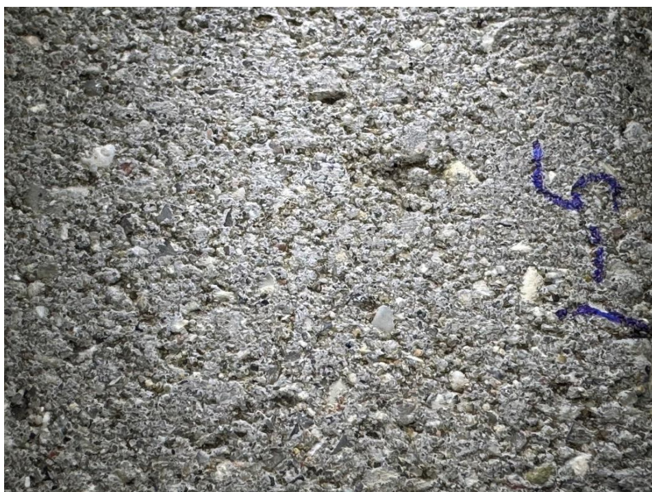
Foto 17 Slidt flise med 1:5 opløsning. Der er fin dækning over hele overfladen og der ses ingen afskalninger.
