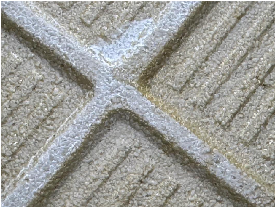
Foto 11 Test panel med opløsning 1:3. Asbest forsegleren dækker hele overfladen. Man kan se, at lagtykkelsen på "ribberne" har været meget tyndere og derfor fremstår de lyse. Men der er stadig asbest forseglert tilbage.
