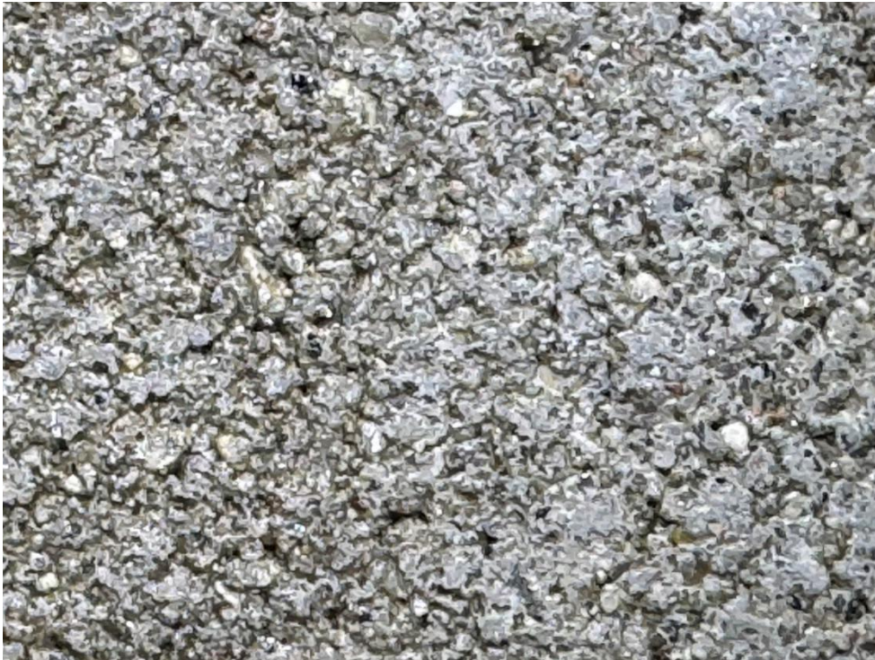
Foto 14 Nyskåret flise i opløsning 1:3. Der er tykt lag af asbest forseglers nede i strukturen, og der er ingen toppe der er uden forseglers.
