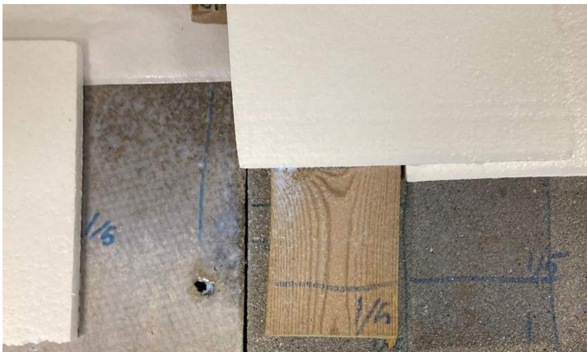
Foto 3: Die Platten sind mit Asbestversiegelung besprüht.
