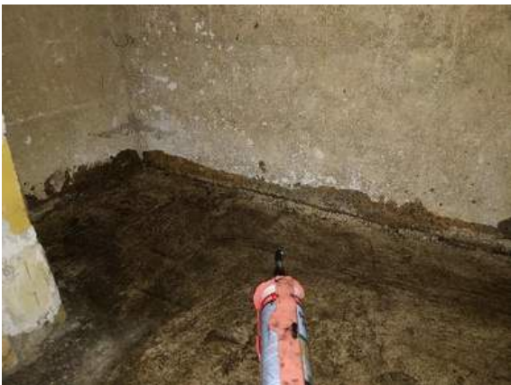
#5 Kriechkeller – größere Risse werden mit geeignetem Dichtungsmittel abgedichtet.
