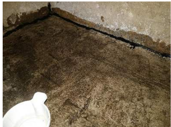
#6 Kriechkeller – größere Risse werden mit geeignetem Dichtungsmittel abgedichtet.
