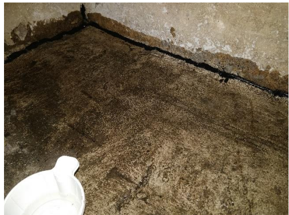
#6 Krybekælder - større revner tættes med egnet fugemasse.
